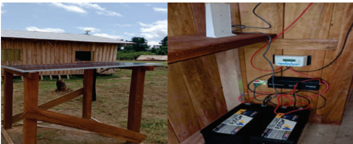
Figura 6: Kit de radiofonia, movido a energia solar, instalado na região de Xamani – Terra Indígena Yanomami.
